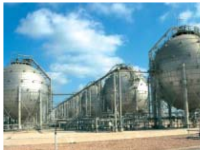
LNG Tanks, Western Desert Gas Complex.
